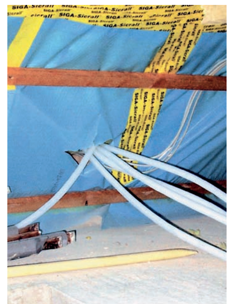
5 Die Elektroinstallation zerstörte hier nachträglich die Dampfbremse/Luftdichteitzebene.
