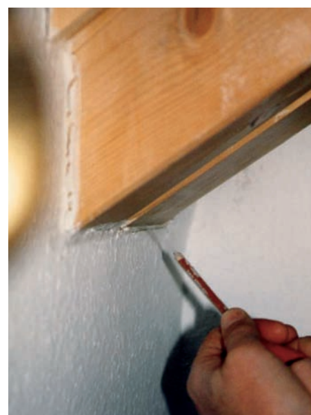
2 Durchdringung der Traufwand durch die Sparren bei einer Aufsparrendämmung: Die Luft strömt durch die Anschlussfugen. →
