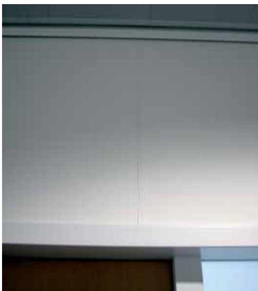
5 Vertikale Fuge oberhalb einer Tür, durch Klima-wechsel bedingtes Schwinden der Platte, reduzierte Fugenlänge und Unterkonstruktion oberhalb der Tür.
